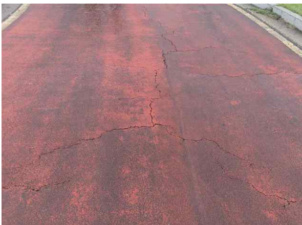
<진입로 포장부 망상균열>
