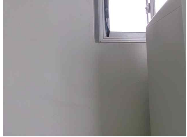
<전기실 내부 벽체 균열>
