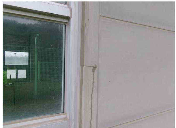
<전기실 외부 벽체 균열>
