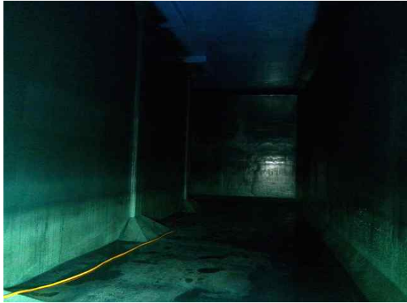
<배수지 1지 전경>
