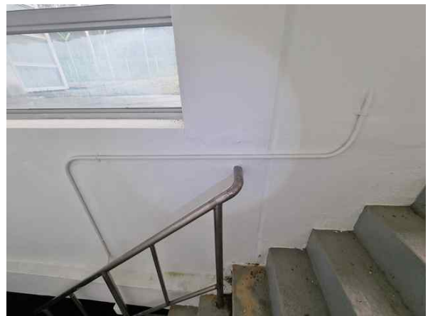
<검수실 내부 벽체 균열>
