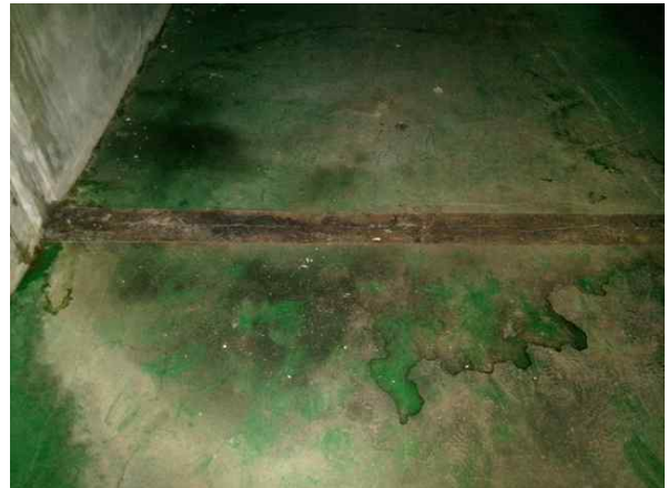
<유입밸브실 바닥슬래브 실링재 열화>
