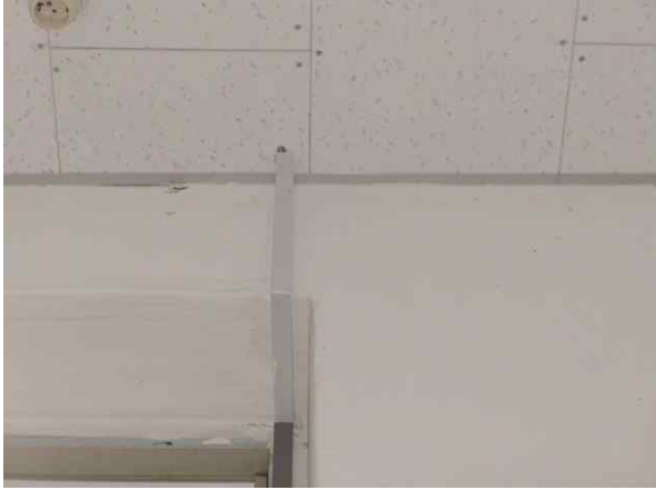
<전기실 내부 벽체 균열>
