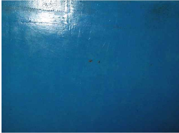
<배수지 1지 상부슬래브 녹>
