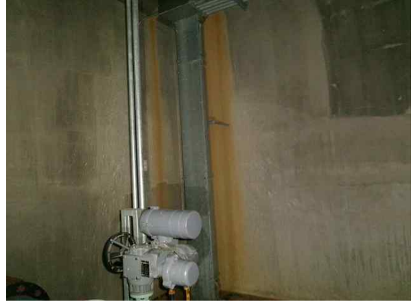
<유입밸브실 벽체 누수흔적>
