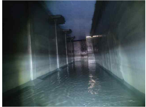
<배수지 2지 전경>
