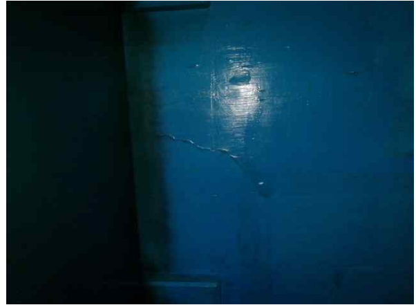
<배수지 1지 상부슬래브 균열>
