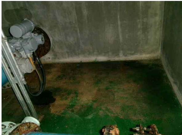
<유입밸브실 바닥슬래브 체수흔적>
