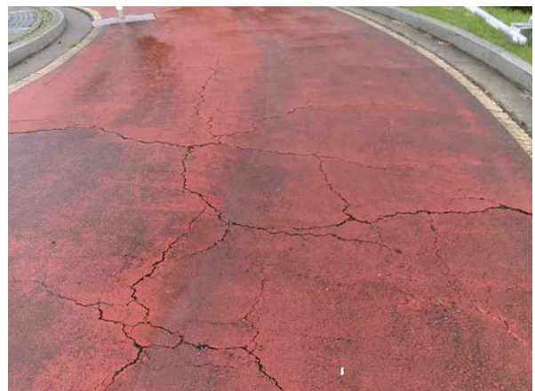
<진입로 포장부 망상균열>
